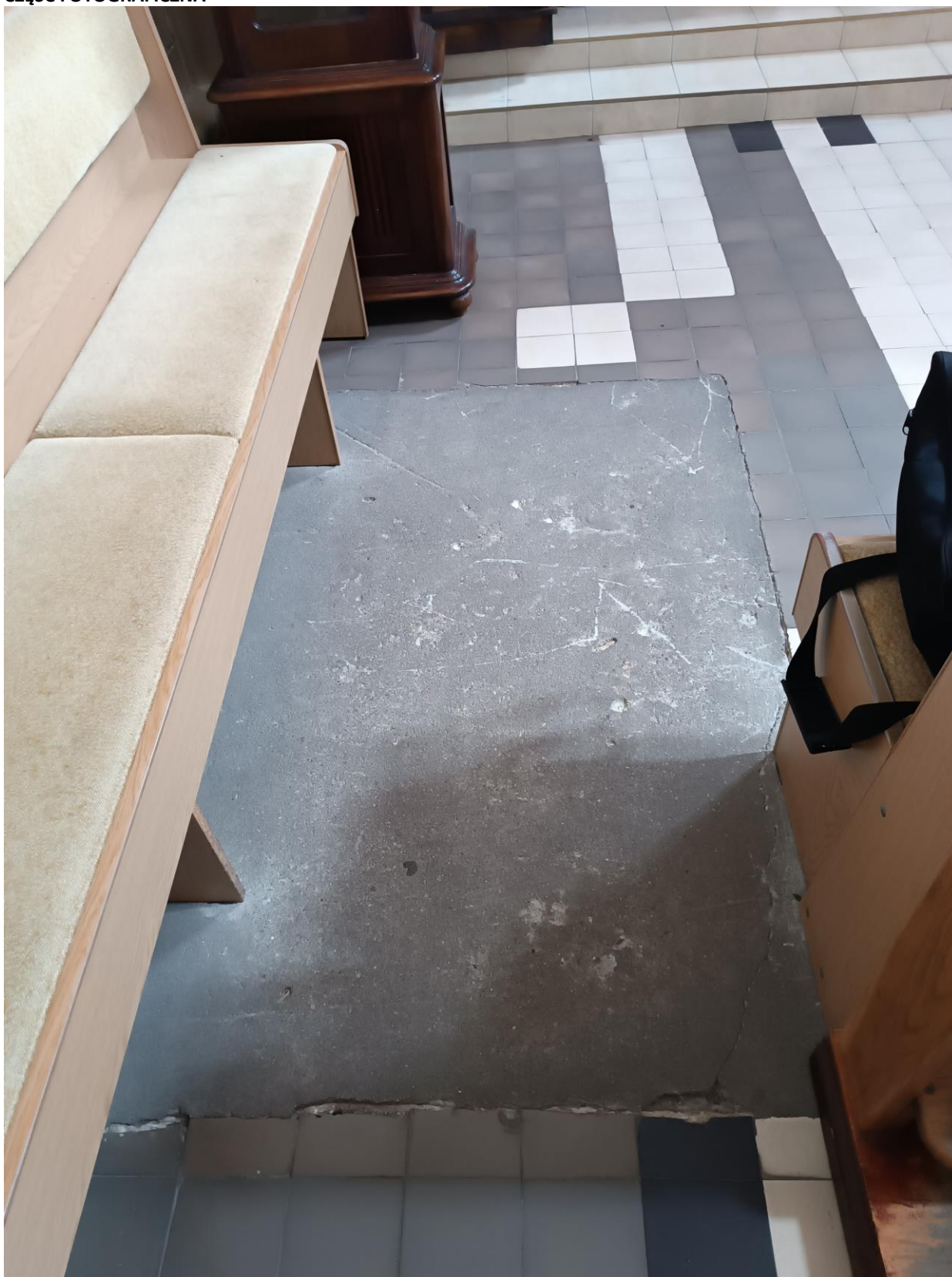
(zdjęcie nr 1 – brak płytek w nawie głównej – strona lewa od drzwi frontowych)
