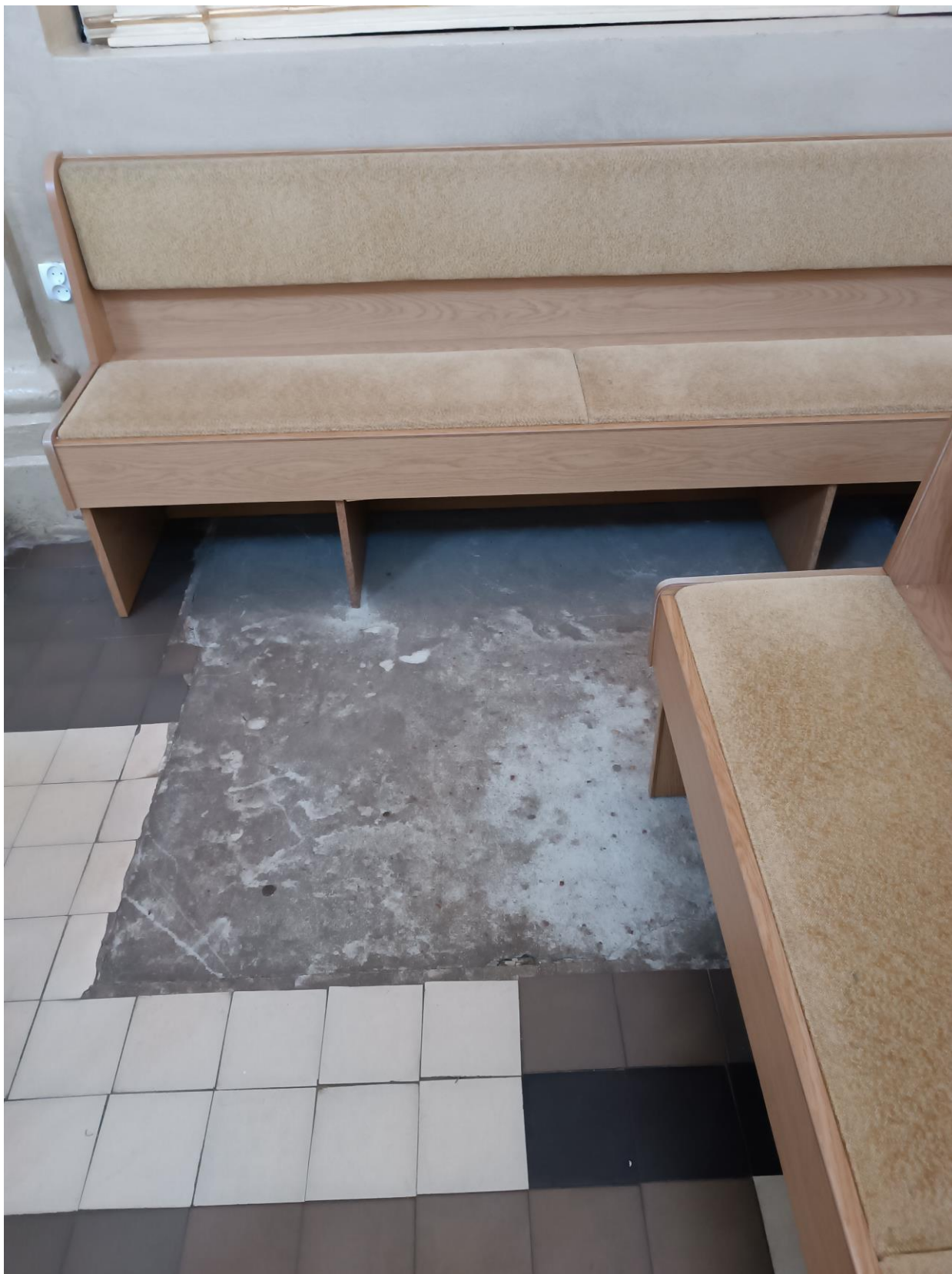
(zdjęcie nr 2 – brak płytek w nawie głównej – strona prawa od drzwi frontowych)
